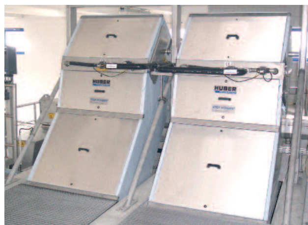
Две установки ступенчатых решеток HUBER STEP SCREEN® SSF, установленные в канале параллельно
