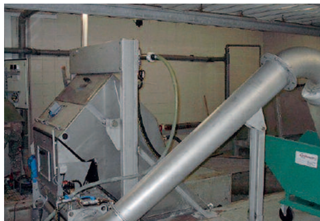
Ступенчатая решетка HUBER STEP SCREEN® SSF с моечным прессом HUBER WAP® для оптимальной механической очистки и обезвоживания. Обработана кислотой в травильной ванне для защиты от коррозии.
