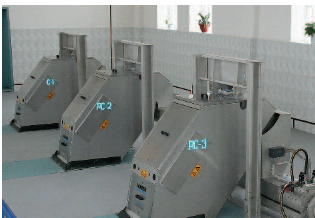
Установки ступенчатых решеток HUBER STEP SCREEN® SSF в России: поворачиваются в канале без необходимости отсоединения последующих моечного пресса HUBER и шнекового транспортера HUBER.
