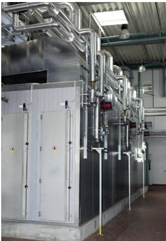
Установка ленточной сушки осадка
