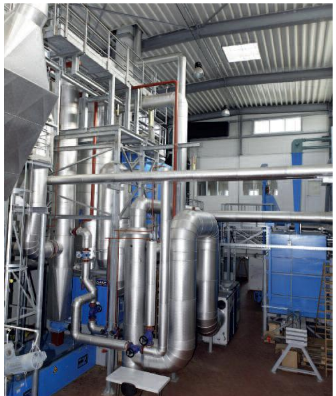
Установка для сжигания осадка
