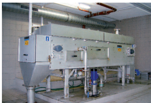
Промывка ленты с помощью фильтрата в качестве воды, распыляемой форсунками
