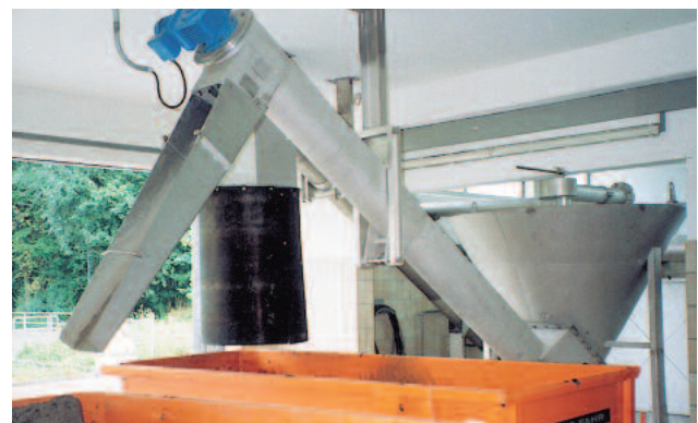
Шнек транспортує пісок з резервуару Коанда у контейнер
