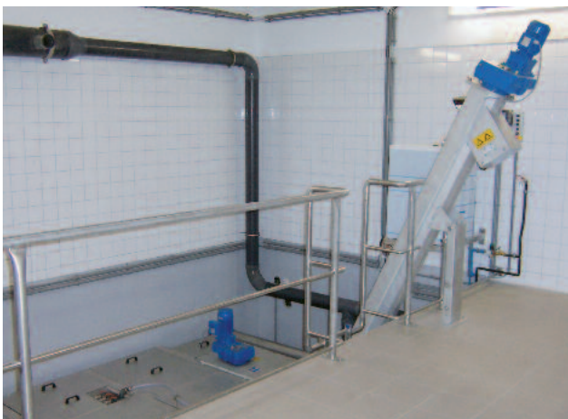
Вмонтований в кінці піскоуловлювача установки Ro 5 піскопромивач
