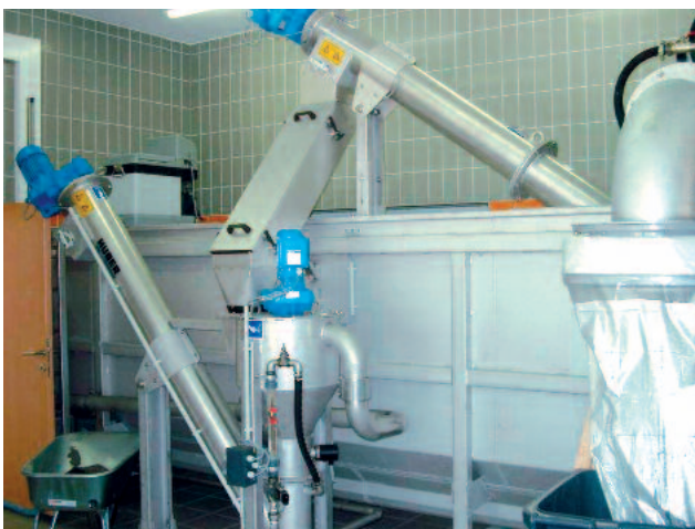
Вивантаження піску з піскоуловлювача у під'єднану установку для промивання сухого піску HUBER RoSF 4/t
